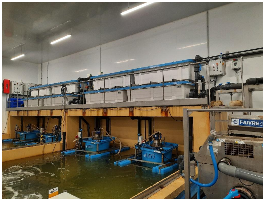
Figure 11 : Les pompes installées au sein de l'atelier du vivier génèrent un bruit relativement important
